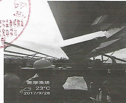
相邻光伏板错位
