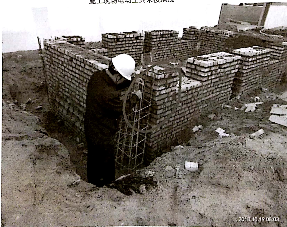
箱变梁柱上口钢筋未制作锚勾
