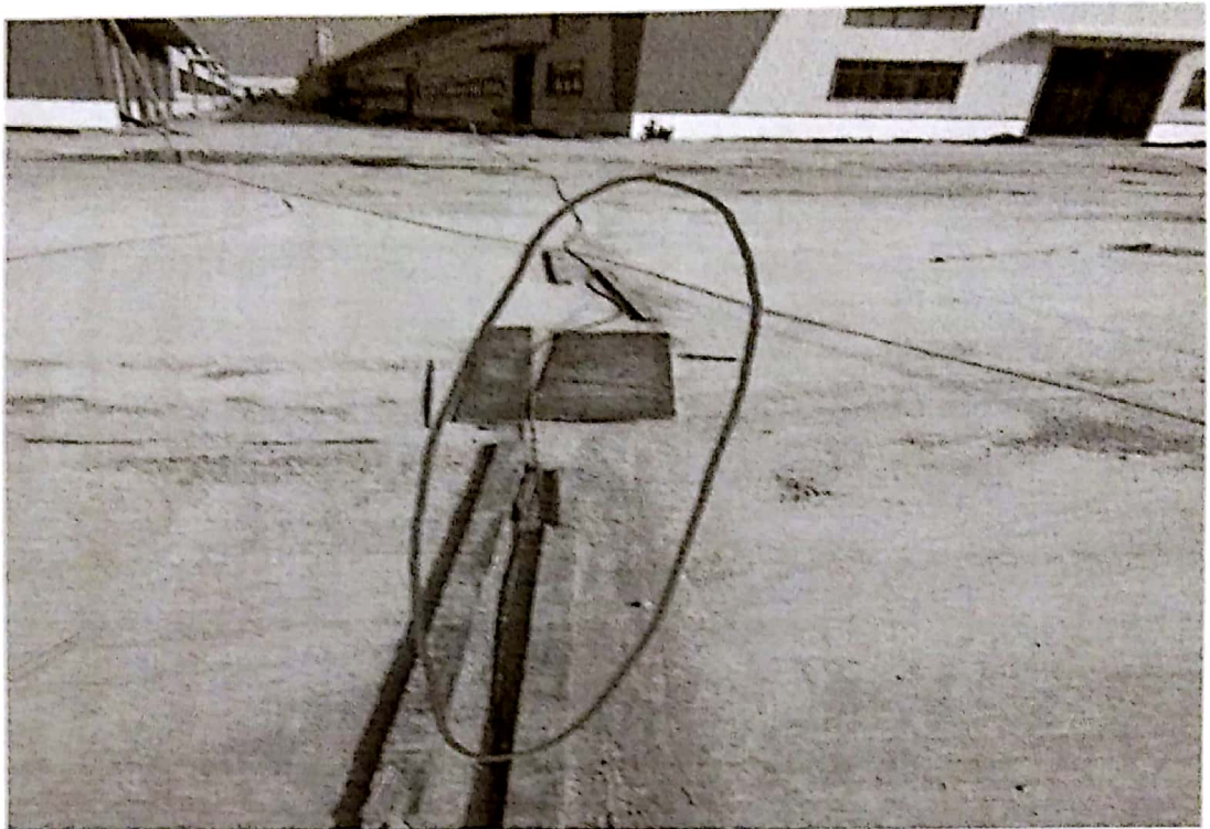
钢管用垫木未做安全防护
