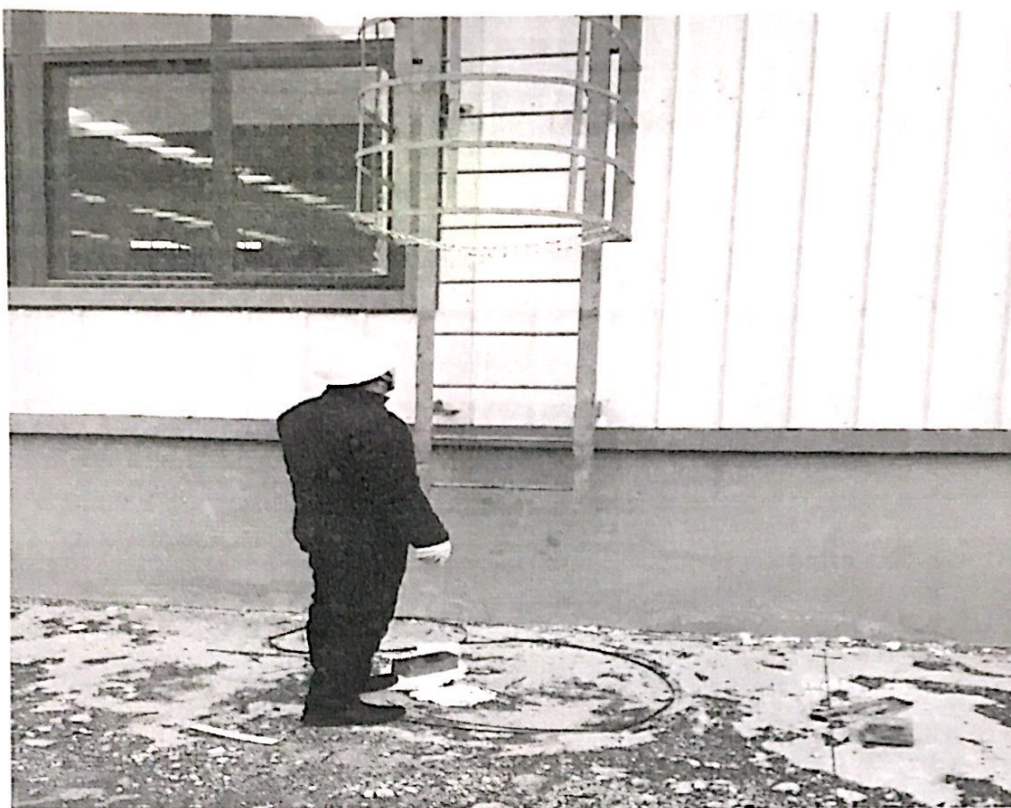
上楼爬梯口处安全防护不到位
