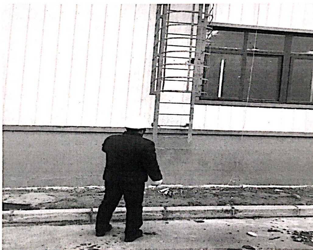
上楼爬梯口处警示标牌掉落
