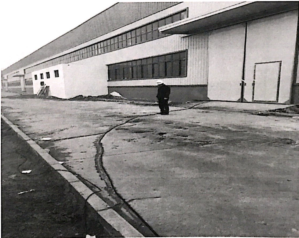
过路电缆线路未做穿管保护
