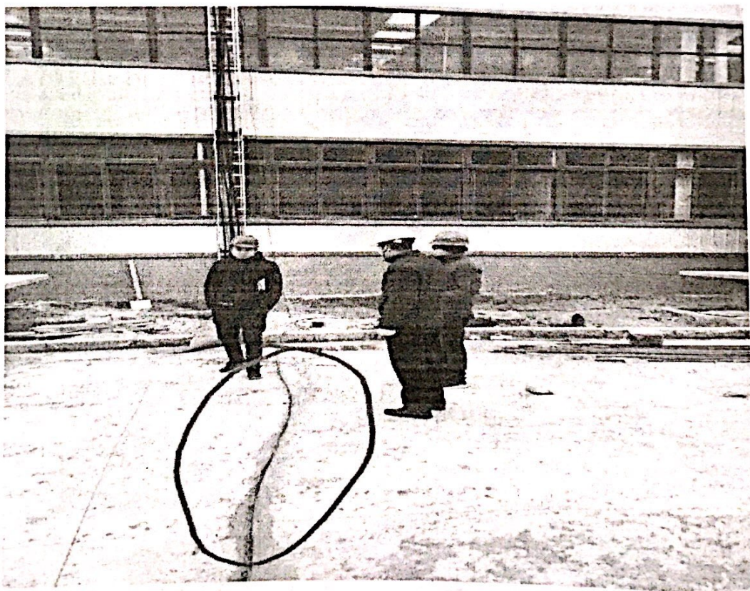
临时用电线路未做安全保护
