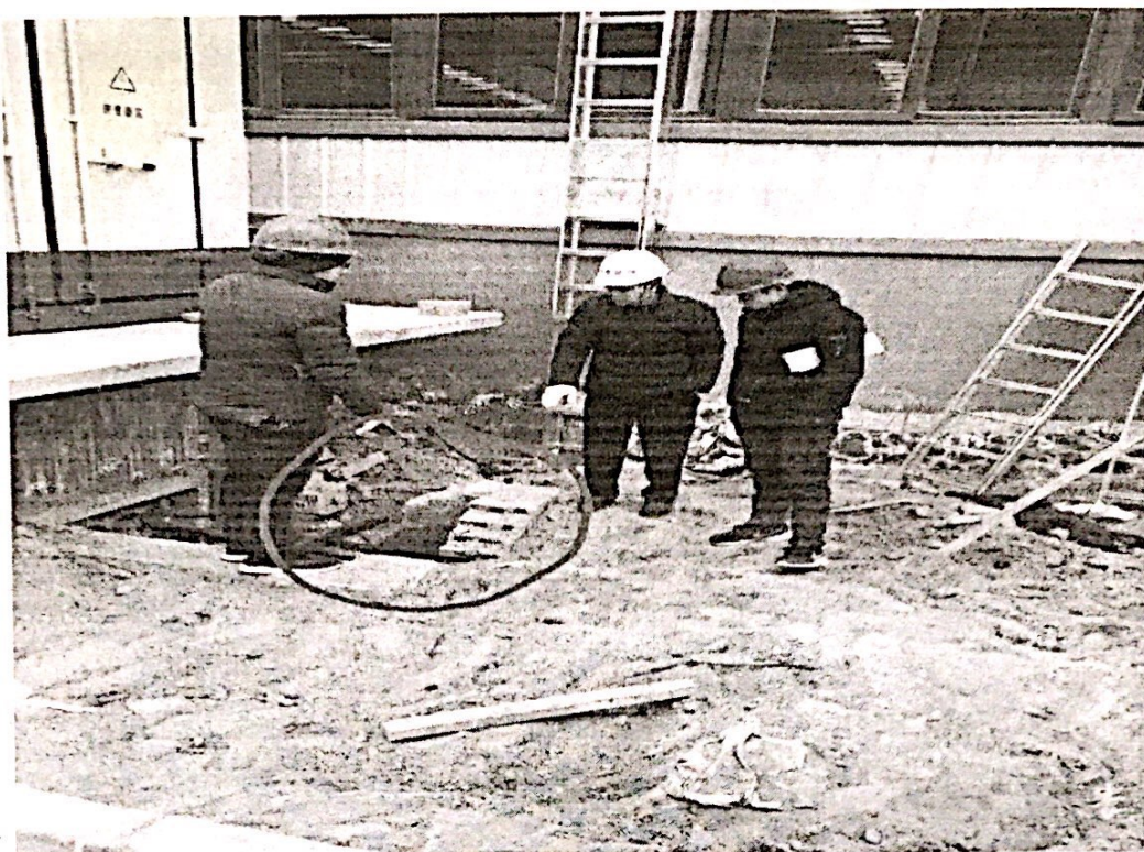
箱逆变设备处电缆井未做防护以及四周施工垃圾清理不到位
