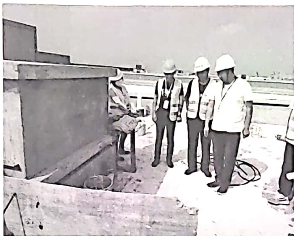
检查临时吸烟区防火设施
