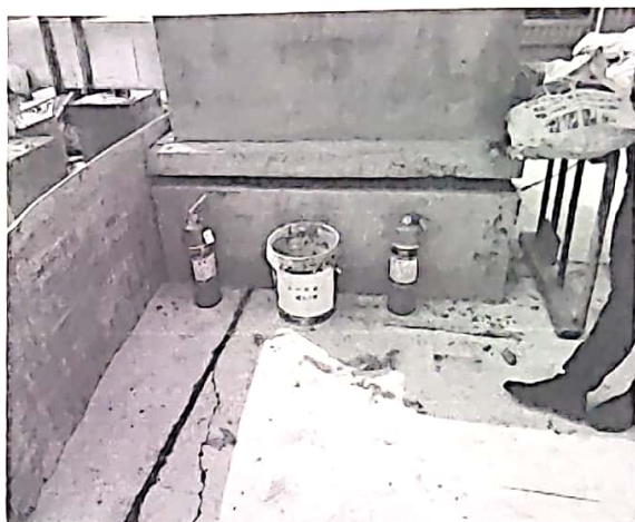
临时吸烟区防火设施
