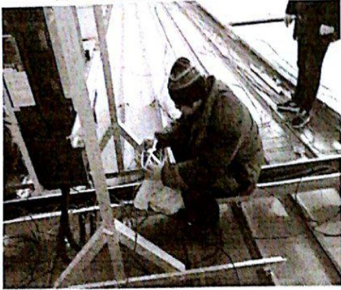
部分施工人员未佩戴安全帽
