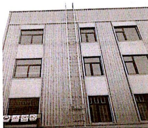
厂房爬梯无安全防护栏
