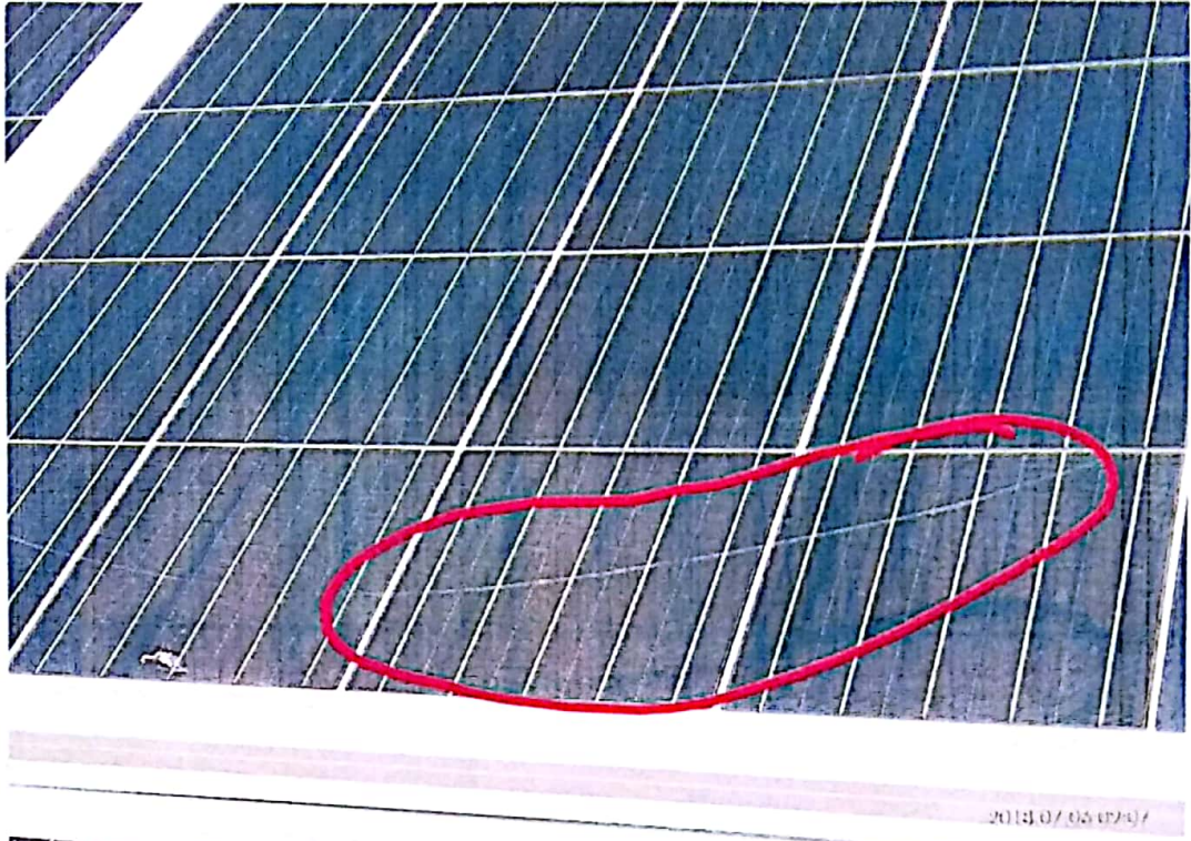
光伏组件表面人为划伤
