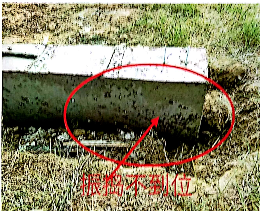
光伏支架基础支墩浇筑问题
