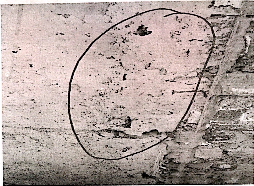
箱变梁柱存在孔洞
