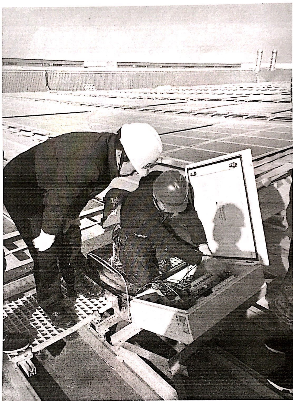
D号屋面光伏组串开路电压检测
