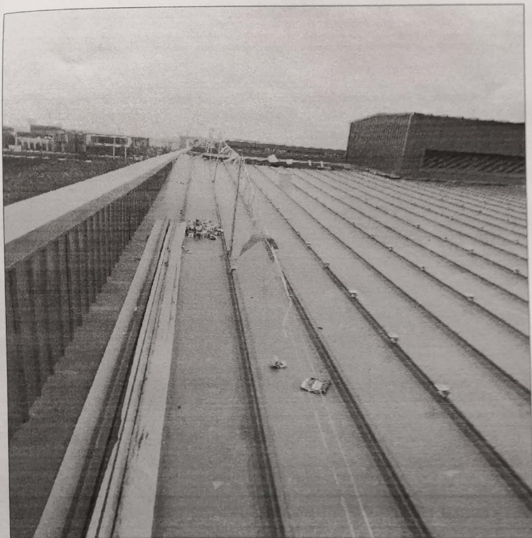
未做安全防护网以及未悬挂安全警示标牌
