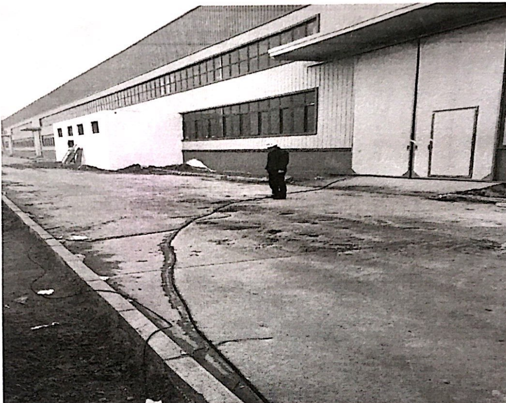
过路电缆线路未做穿管保护
