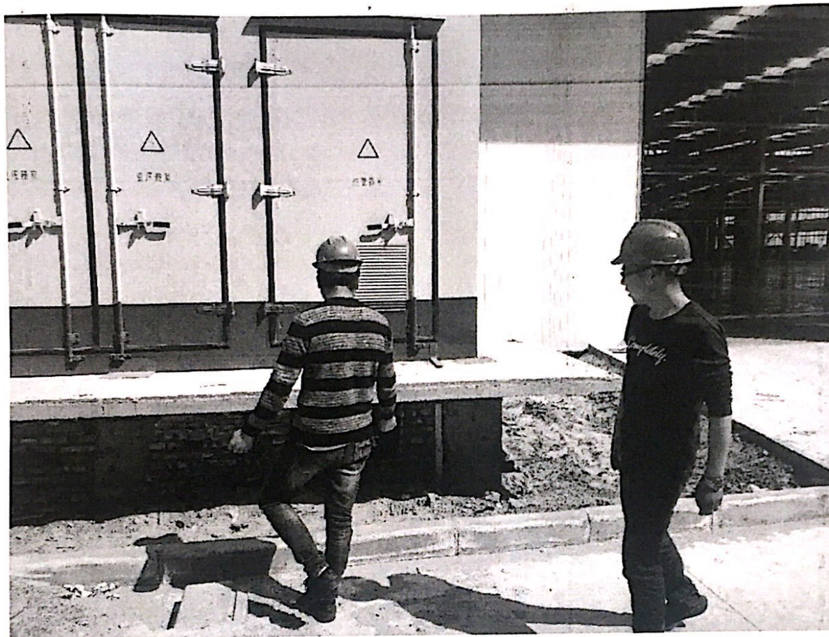
皮阿诺厂区检查电气设备运行情况 03
