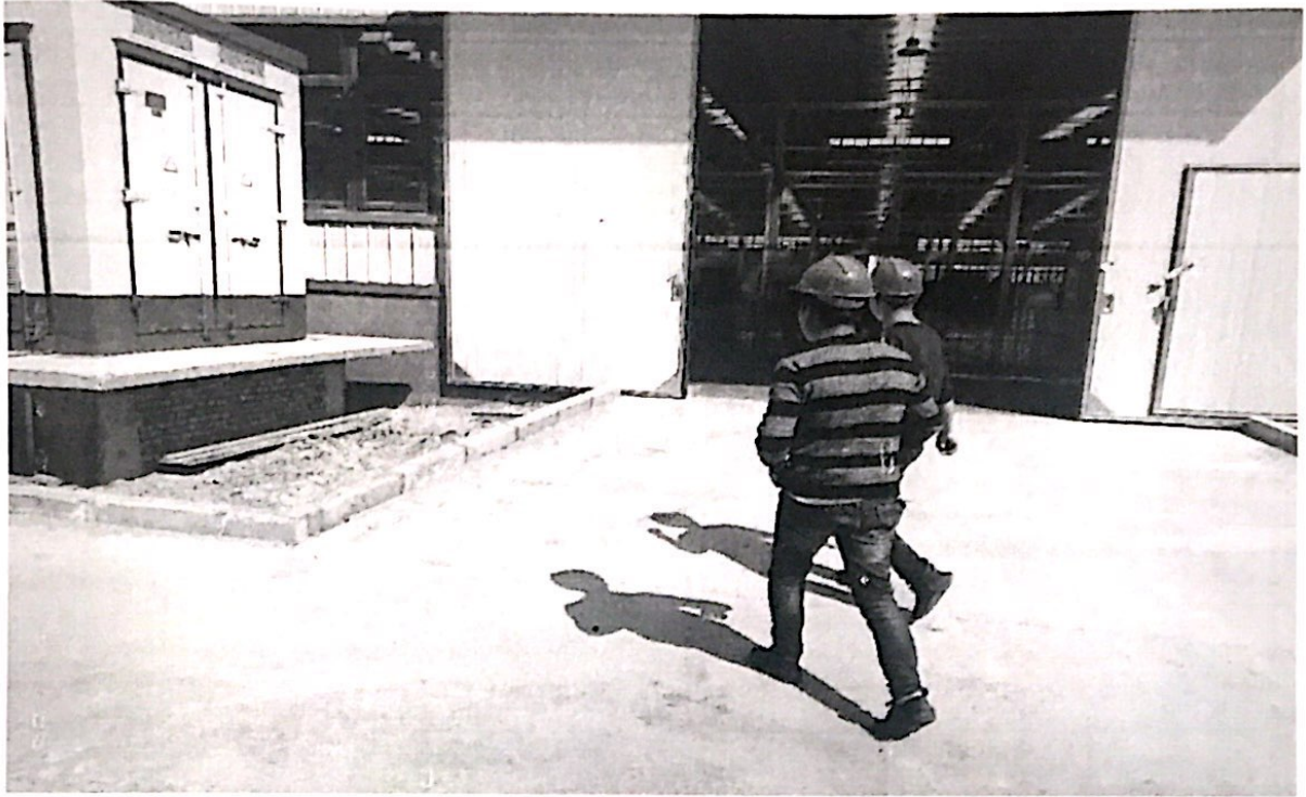
皮阿诺厂区检查箱变设备运行情况 01
