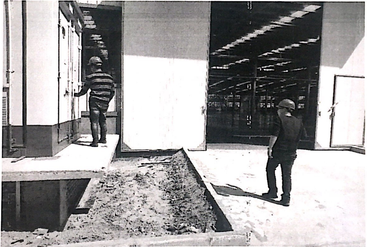
皮阿诺厂区检查电气设备运行情况 02
