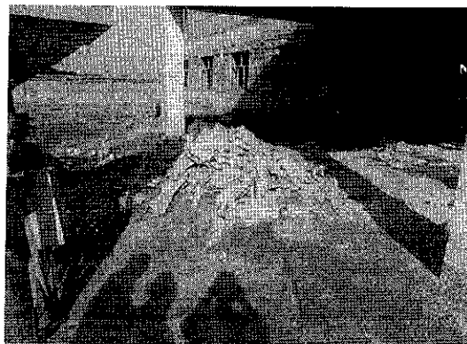
现场施工垃圾过多
