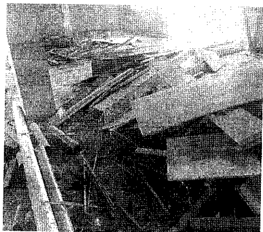
文明施工做的不到位
