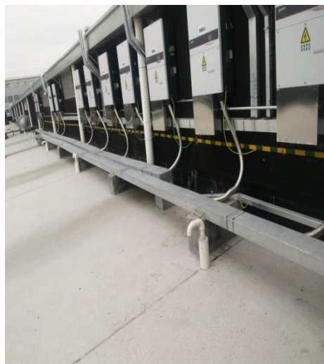
2、现场未见灭火器材
