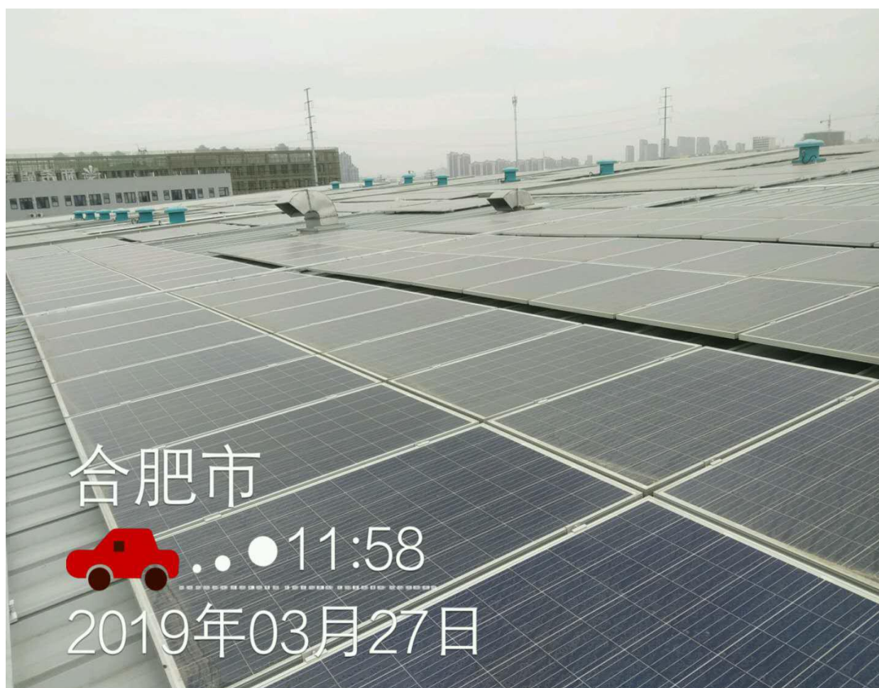
3、光伏场区未见灭火器材
