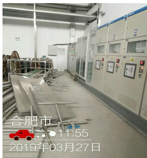
1、配电室内堆放杂物及没有灭火器材
