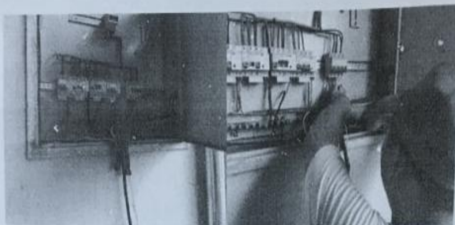
配电箱有杂物、接地线接在零线上
