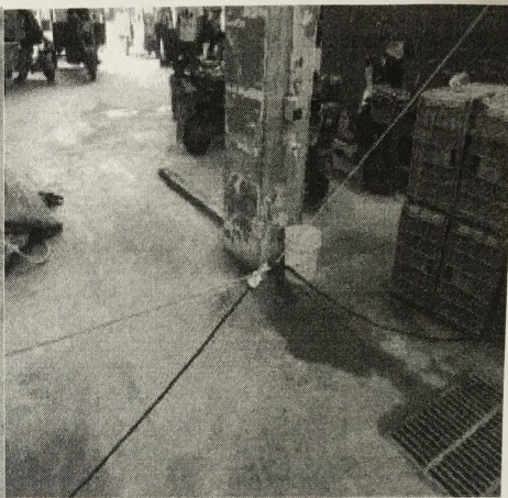
施工电缆影响人员、车辆通行
