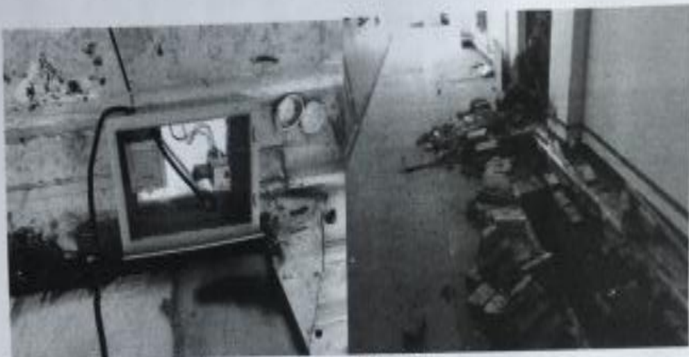
临边防护时配电箱没有盖板
