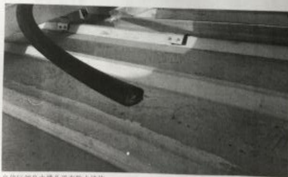
光伏区部分电缆头没有防水措施
