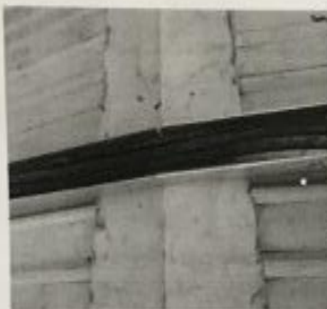
电缆过屋脊没有支撑
