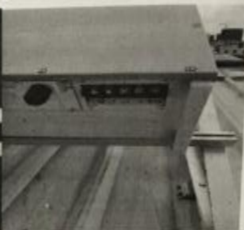
逆变器保护盖未及时安装
