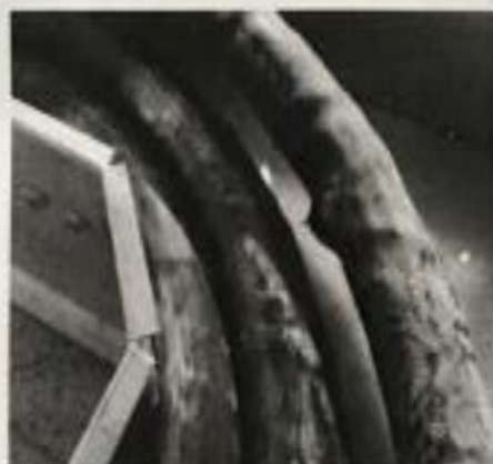
桥架转弯处电缆破横
