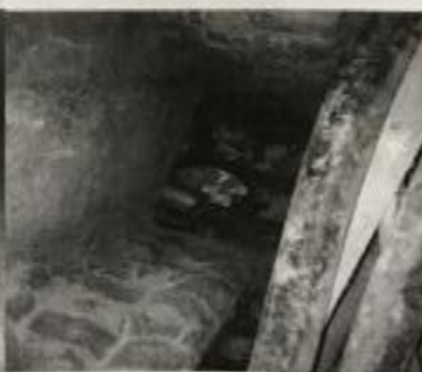
电缆进配电室未及时封堵
