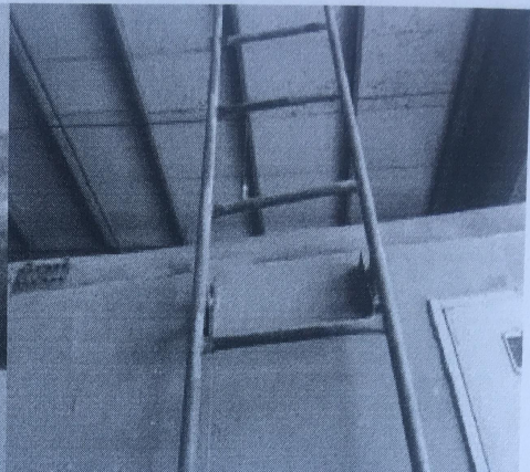
爬梯锈蚀严重
