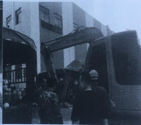
施工人员未佩戴安全帽
