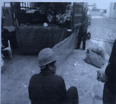
施工人员未佩戴安全帽
