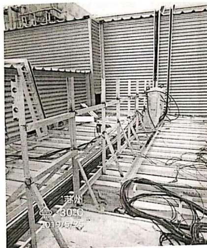
1号楼焊接逆变器时未及时铺防火毯
