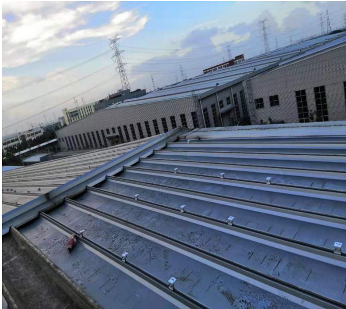
屋面东侧临边防护措施丢失
