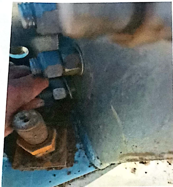
相片一：螺栓未紧固
