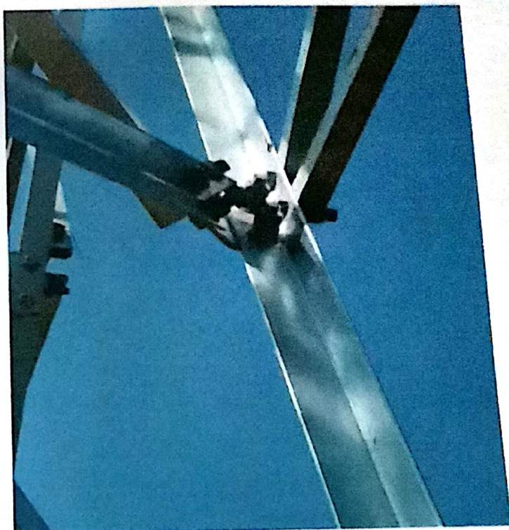
相片二：螺栓未紧固
