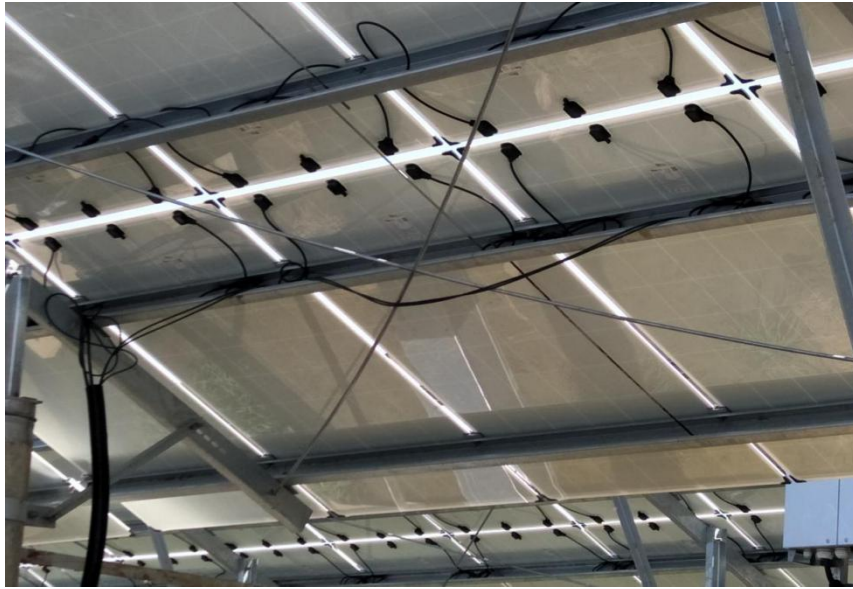
斜拉杆未紧固、组件线需要整理
