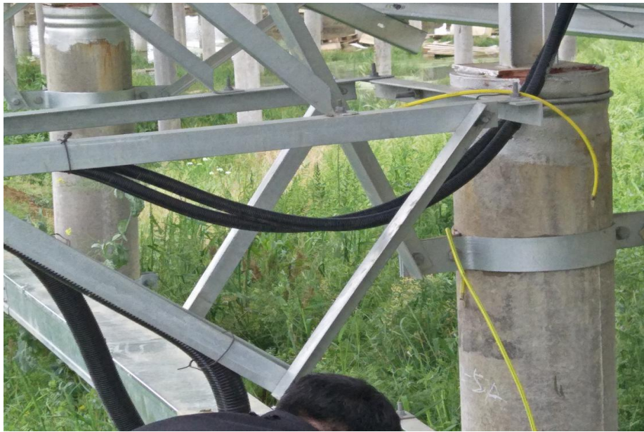
防腐没做、接地断开
