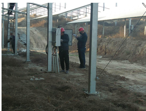
汇流箱检查 12、3 区带电
