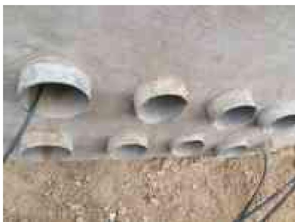
逆变器穿墙套管未做喇叭口
