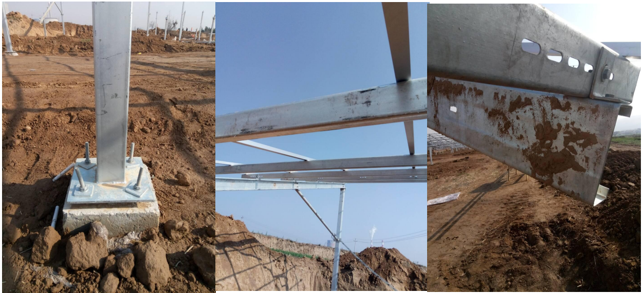
现场问题照片（螺栓安装不规范、檩条镀锌层被破坏、横梁上有泥土）
