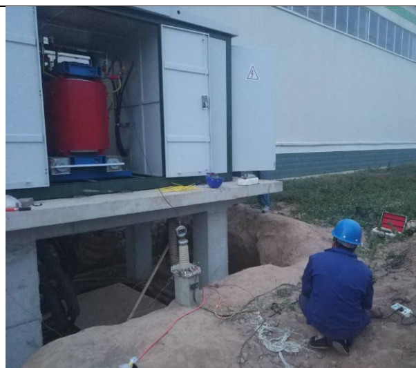
箱式变压器高压试验
