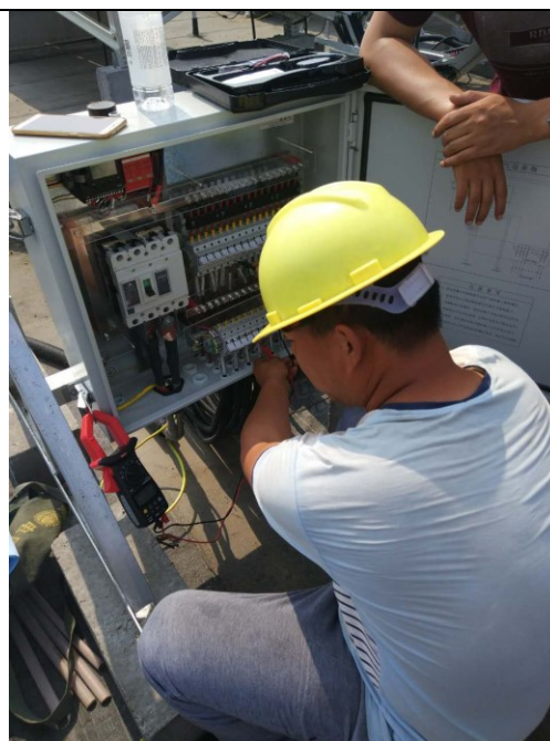
汇流箱电压检测
