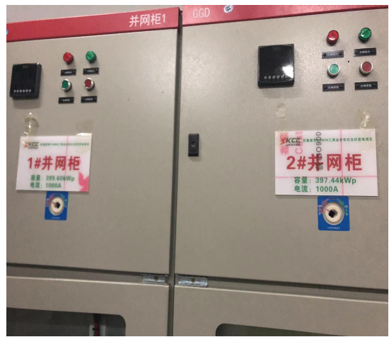
热缩套管破损需修补
