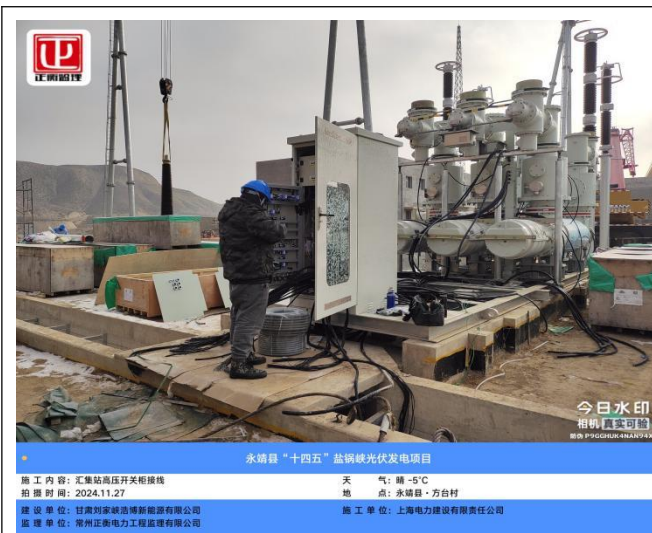
汇集站高压柜接线
