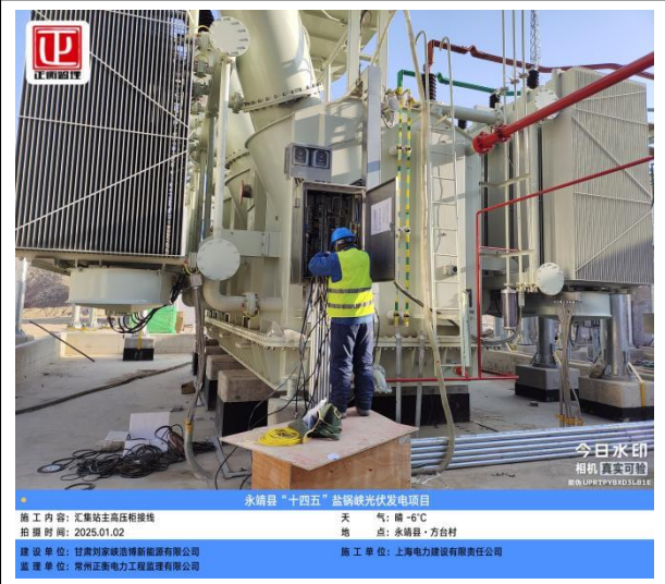
高压开关柜接线
