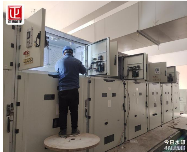
汇集站 35KV 配电室高压柜接线
