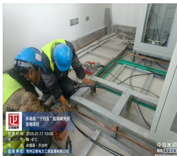
汇集站二次室配电柜接线
