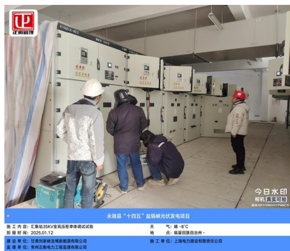
汇集站 35KV 室高压柜单体调试
