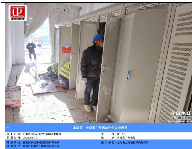
汇集站 35KV 保护小室接线
