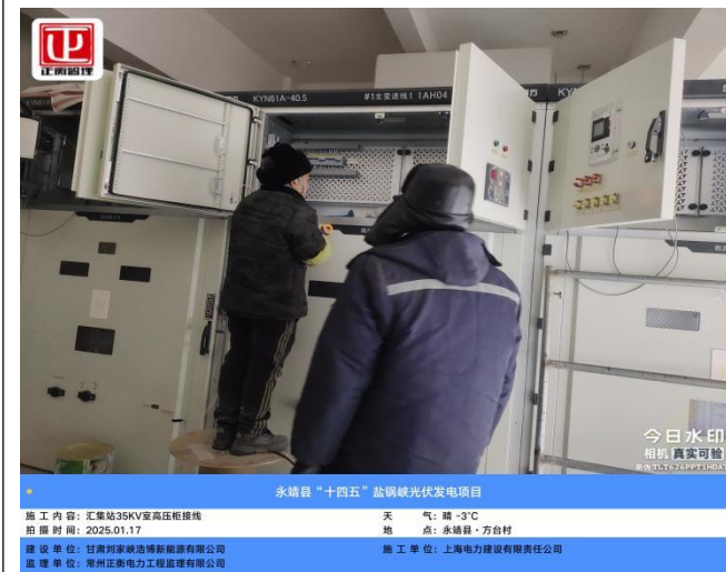
汇集站 35KV 高压柜接线
