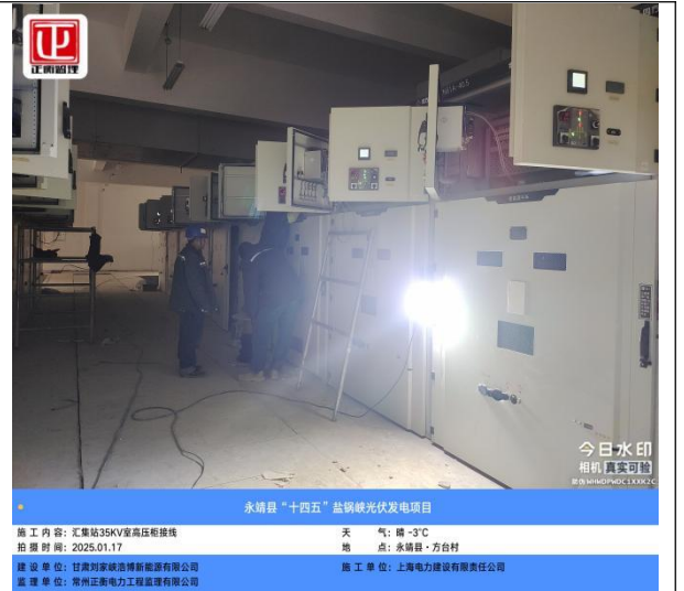
汇集站 35KV 高压柜接线
