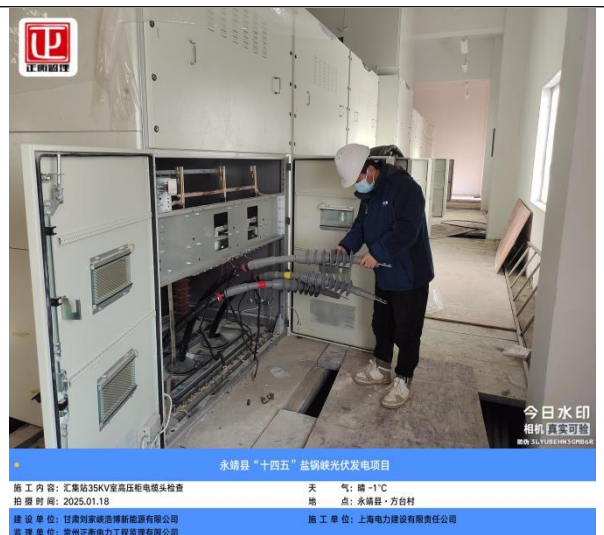
汇集站 35KV 高压柜电缆头检查
