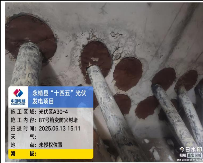
箱变电缆防火封堵
