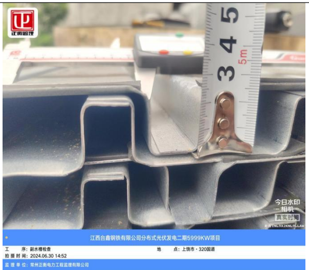
副水槽高度检查
