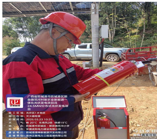
监理巡查一地块灭火器检查
