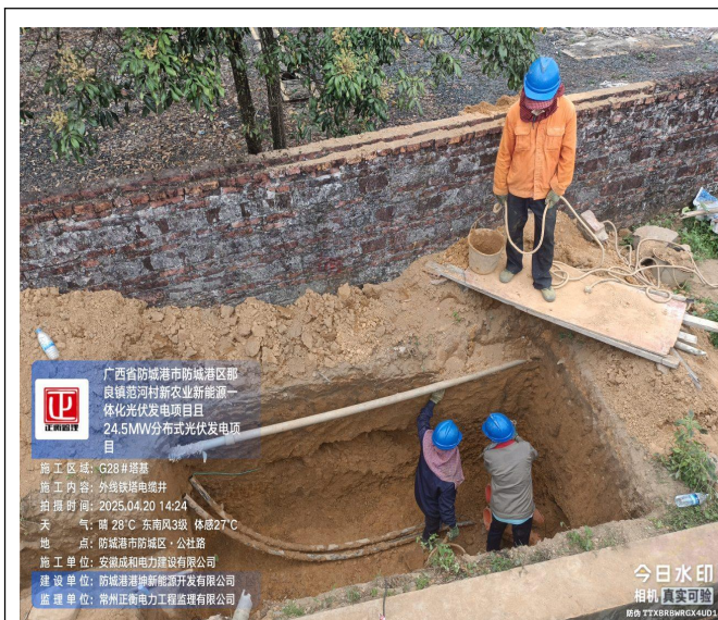
监理巡查外线 G28 塔基电缆井
