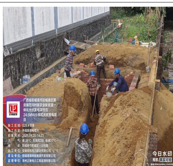
监理巡查外线 G28 塔基电缆井
