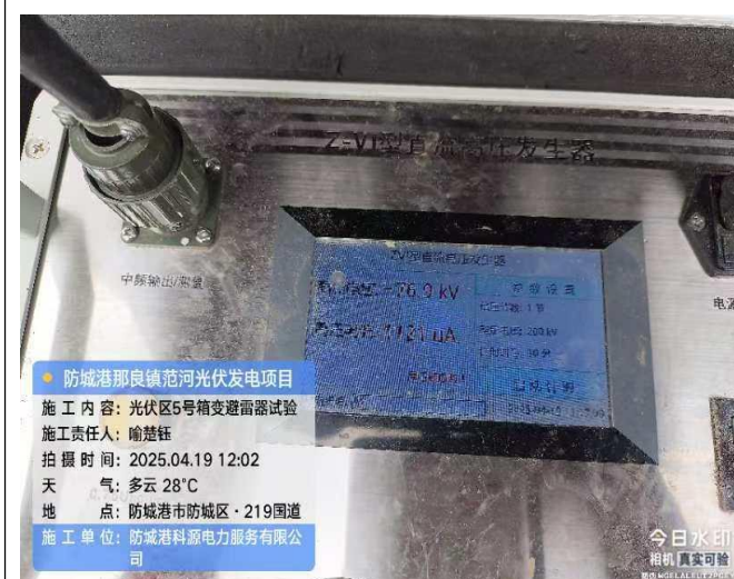
监理巡查光伏区 5 号箱变避雷器试验
