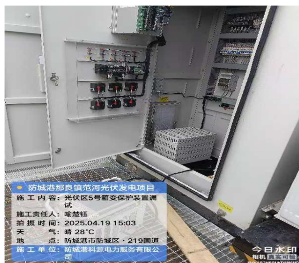
监理巡查光伏区 5 号箱变保护装置调试
