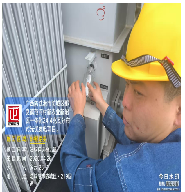
监理巡查光伏区升压站 5 号箱变取油样
