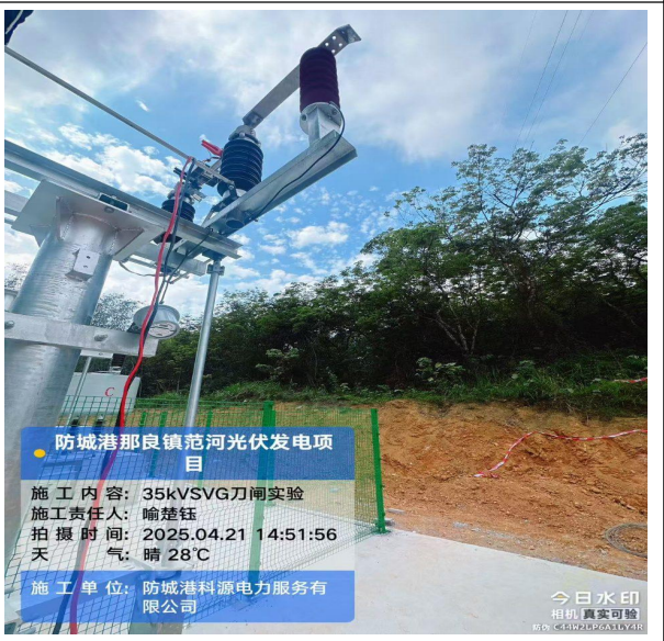
防城港那良镇范河光伏发电项目
