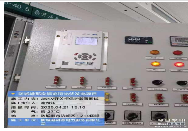
防城港那良镇范河光伏发电项目
