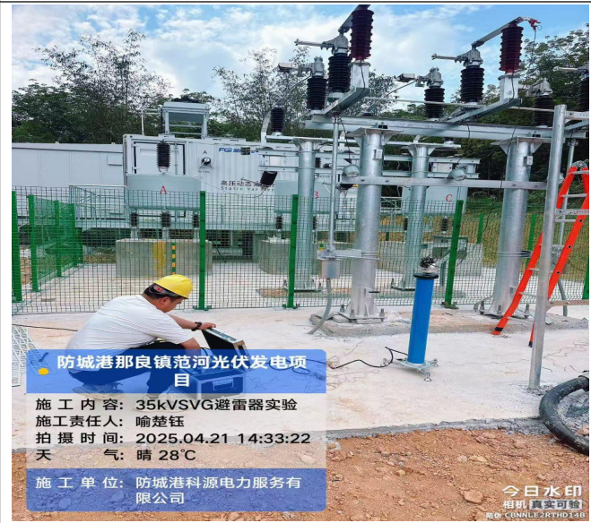
防城港那良镇范河光伏发电项目
