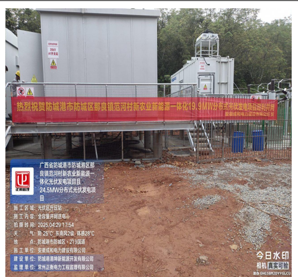
监理巡查光伏区升压站顺利并网发电
