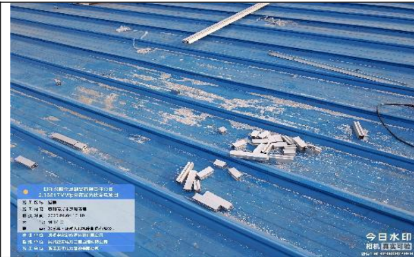
现场施工结束碎屑未及时清理
