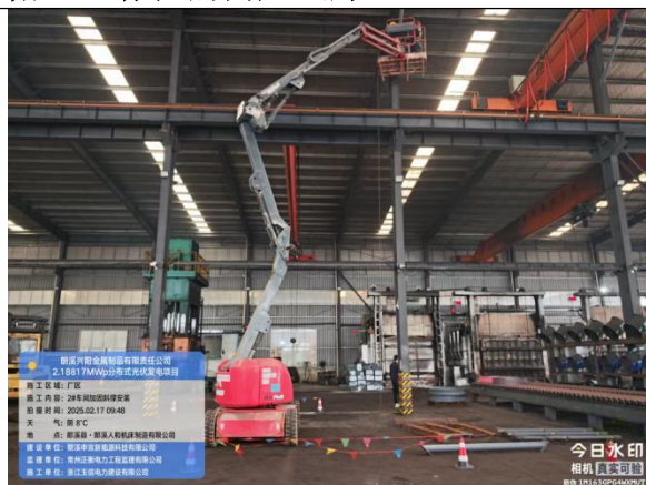
现场加固未配备安全员
