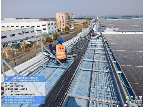
临边作业未佩戴安全带
