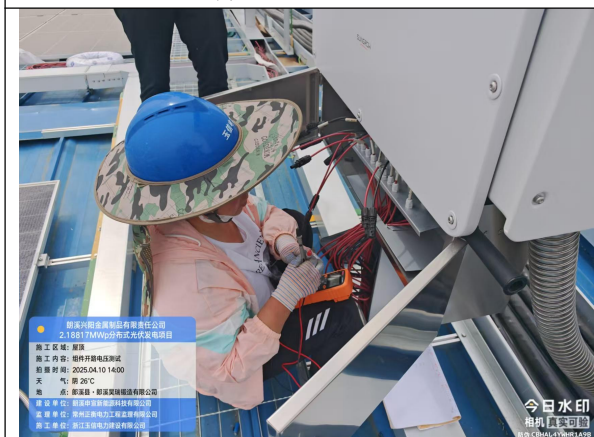
组串开路电压测试
