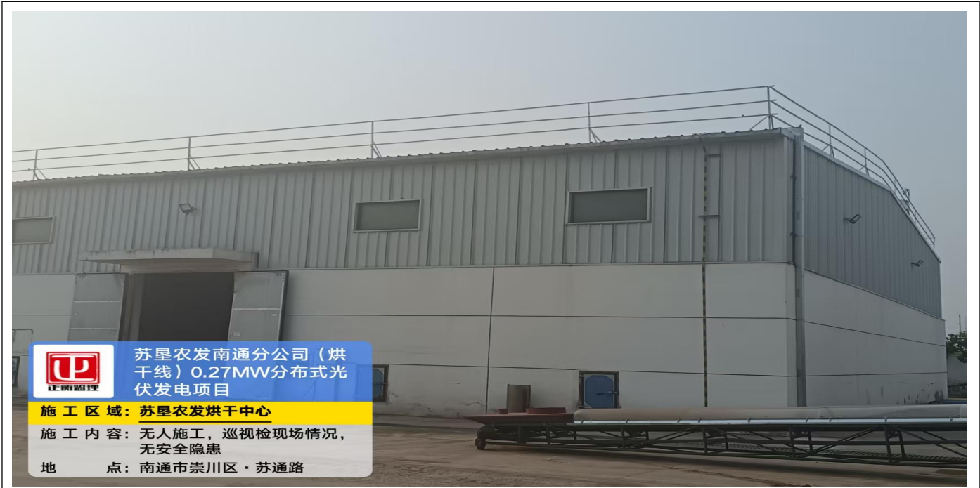
无人施工，厂内忙碌，爬梯底部缺少，未能上屋面检查
